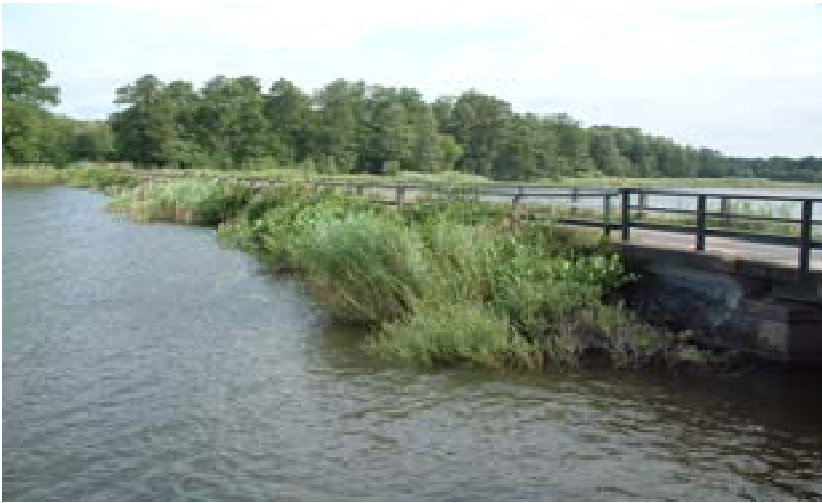
Bild 3.2 Bro och vägbank till Ängsö i Västmanland översvämmas vid högvatten
