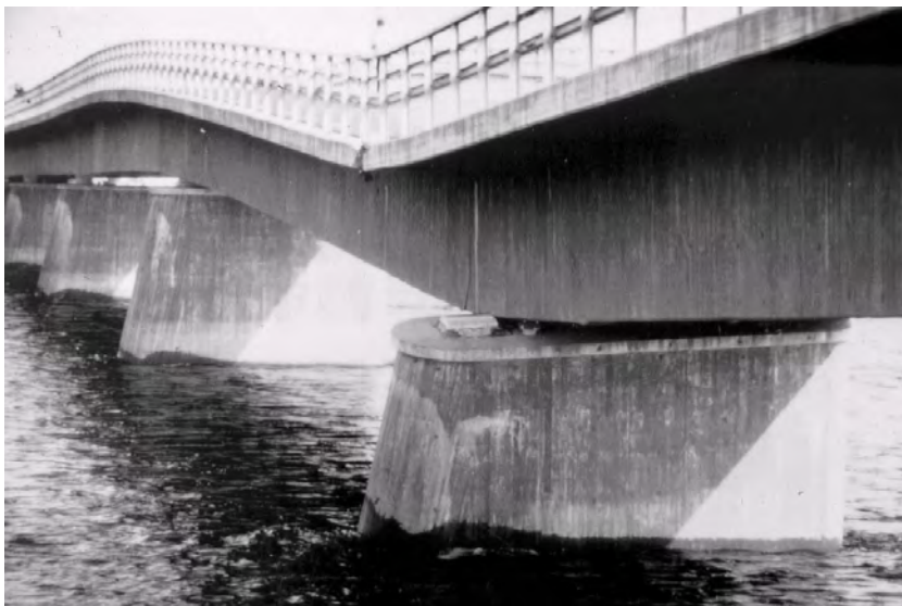
Figur 4 Erosionsskada vid Kangosfors i Lainio älv 1975
