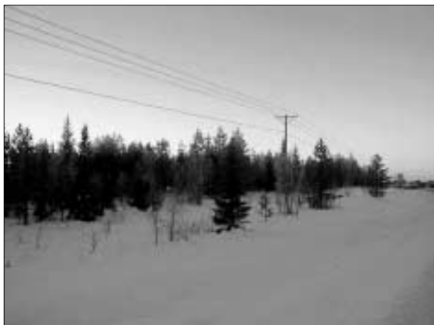
Figur 8. Upphängning av kablar i kraftledningsstolpar. Den undre kabeln är bredbandskabel. (Foto: Roland Lundqvist)
