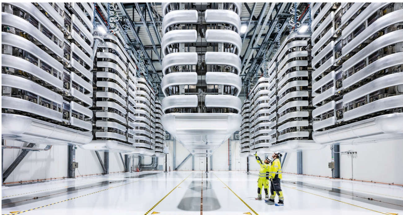
Konverteringsstation för högspänd likström (HVDC) i Emden, Tyskland, överför elektricitet för upp till en miljon hushåll från havsbaserad vindkraft i Nordsjön. Källa: Hitachi Energy, Ludvika
